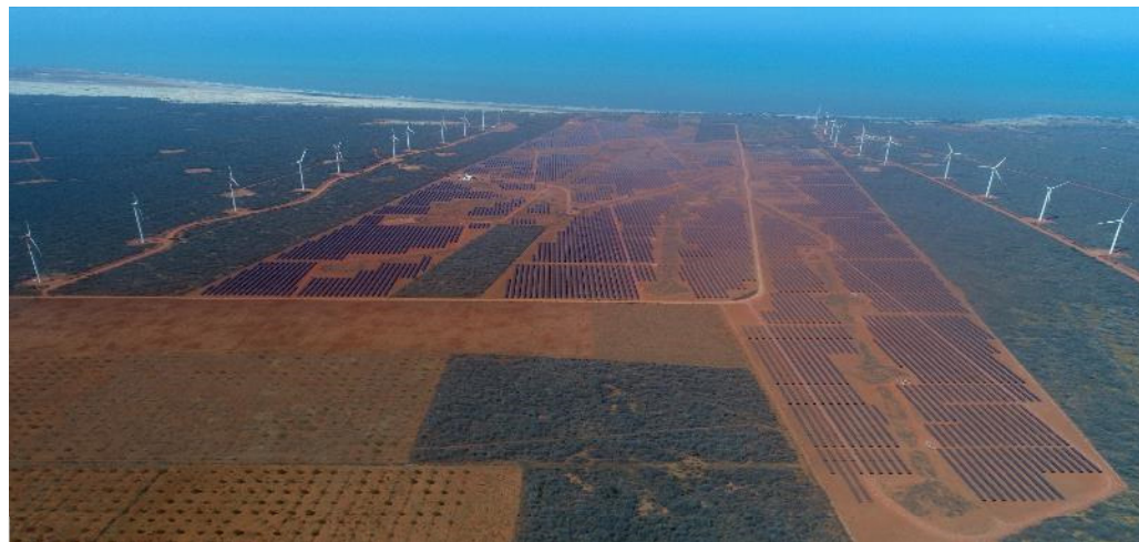
UFV de 101 MWp em Areia Branca (RN).
