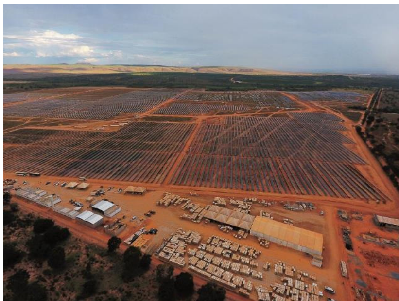
UFV de 185 MWp em Pirapora (MG).
