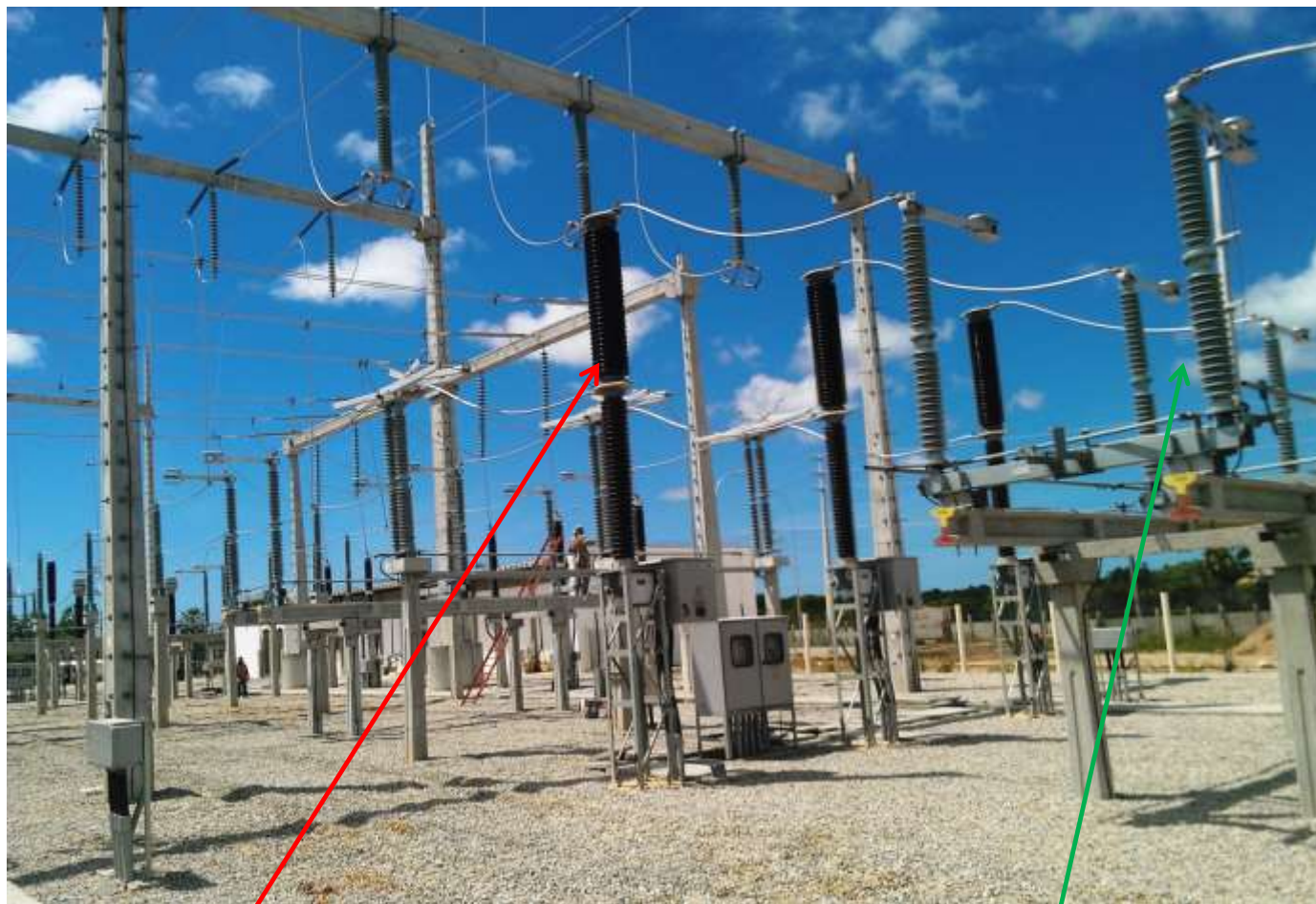
Disjuntor sem RTV
