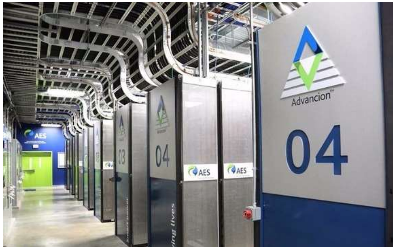
AES 10 MW (of 100 MW) BESS na Irlanda do Norte
