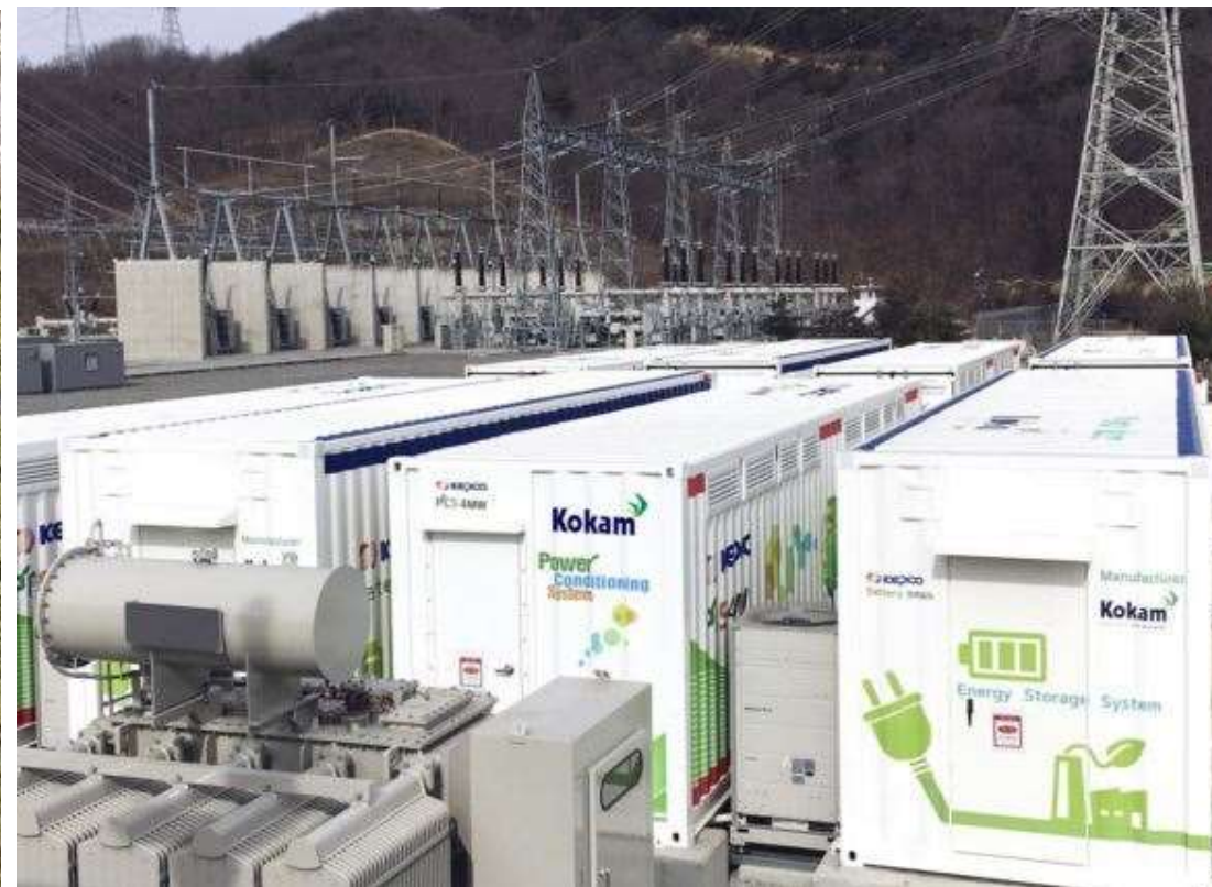
Kokam 56 MW Energy Storage na Coreia do Sul
