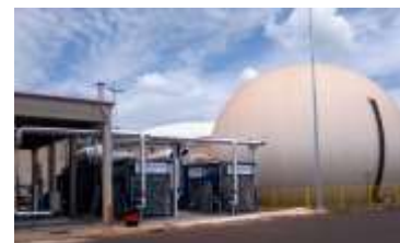
CHP Biogás – 1,5 MW ETE, Ribeirão Preto
