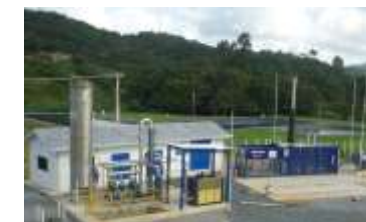
Biogás – 1 MW Aterro Sanitário, Itajaí
