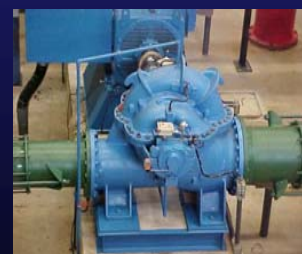
Comandos de Bombas
